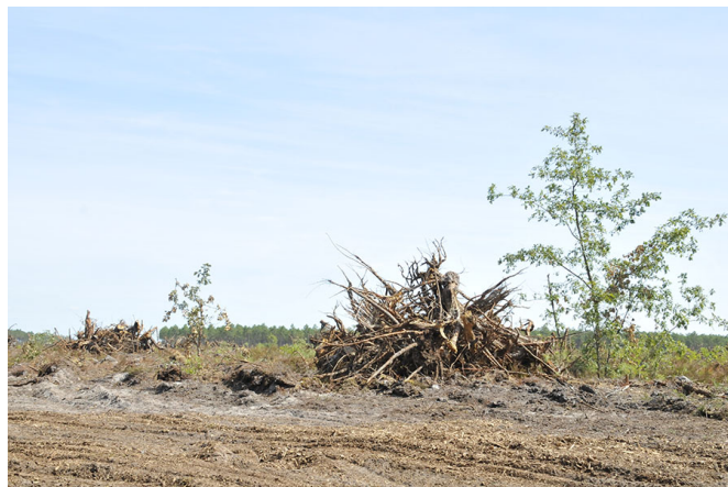
Coupe à blanc d'une parcelle sur laquelle on a retiré les souches pour alimenter la filière du bois énergie ©Eric Castex
